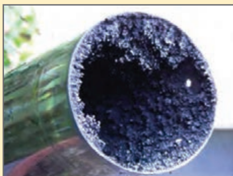
دوده ایجاد شده در داخل لوله
