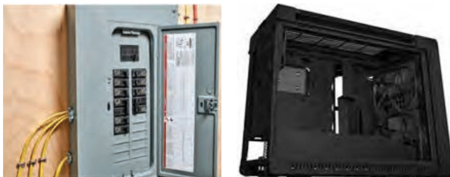
شکل ۳۱- کیس رایانه و تابلو برق
