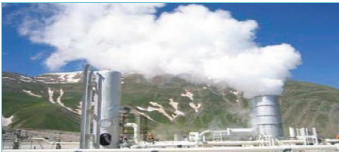
شکل ۲۴-۵- تأسیسات زمین گرمایی مشکین شهر
