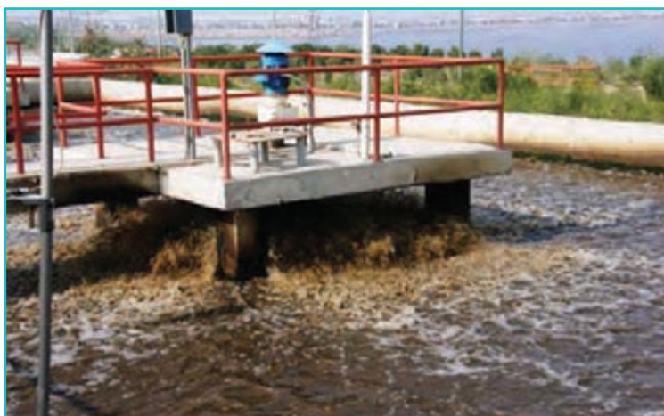
شکل ۵-۶- تصفیه‌خانه فاضلاب ارومیه
