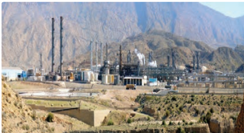
شکل ۱۲-۱۳- تأسیسات گازی پارس جنوبی
