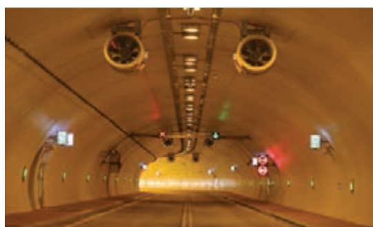
شکل ۱۸- تهویه‌های هوای نصب شده در تونل
