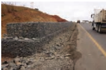
شکل ۱۰- دیوارهای گابیونی کنار راه
