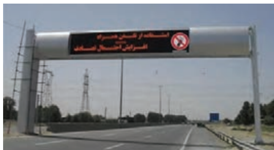
شکل ۱۶- نمایی از تابلوهای پیام متغیر
