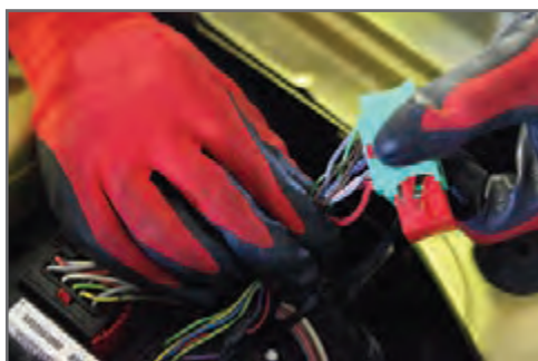
سفت بودن اتصال سیم‌ها به کانکتورها
