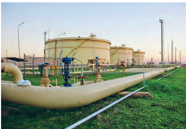
شکل ۲۱- نمایی از خطوط انتقال سوخت
