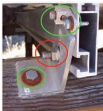
شکل ۵۶- پیچ متصل به سازه فرسوده شده است
