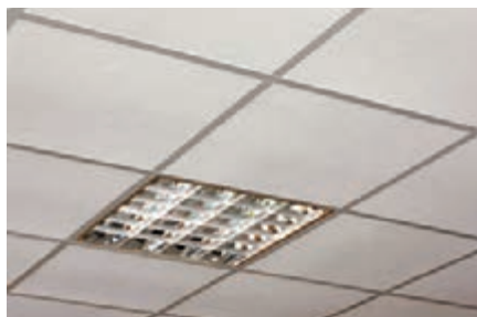
شکل ۳-۴- سقف کاذب مشبک
