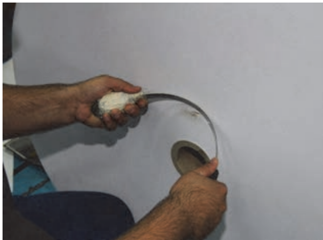
شکل ۵- برطرف کردن آسیب روی بدنه رول
